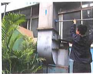
FQ-01263废气排放口
