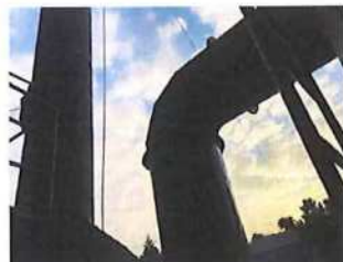
FQ-01262废气排放口
